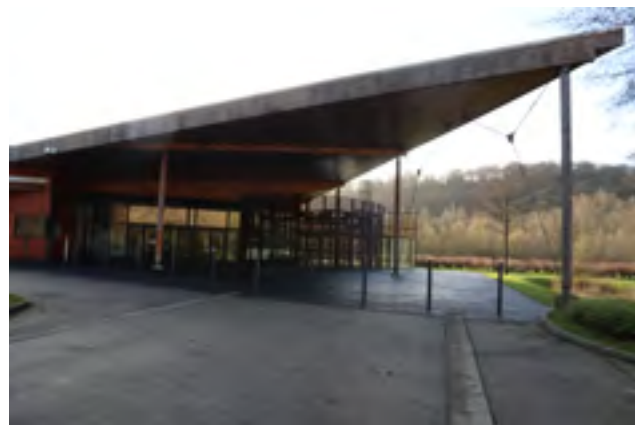
Début décembre, et afin d'éviter d'éventuelles chutes, l'enrobé du parvis de la salle des Aulnes a été refait suite à des affaissements.
